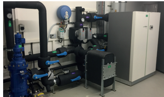
Systemtrenner in Brühl-/Grabäckerstrasse, Spreitenbach
