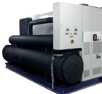
Anlagenbau (Wärmepumpe für ARA Steinach)
